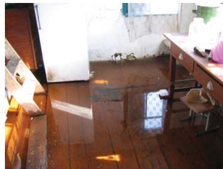
Вода в жилых домах в г. Щучье в период таяния снега
