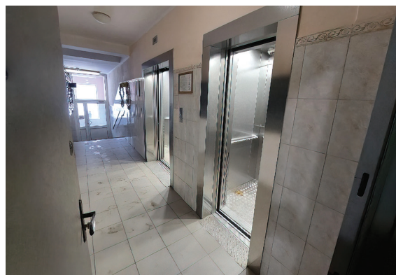
Фото 4. Новые лифты OTIS. Фото предоставлено правлением ТСЖ.
