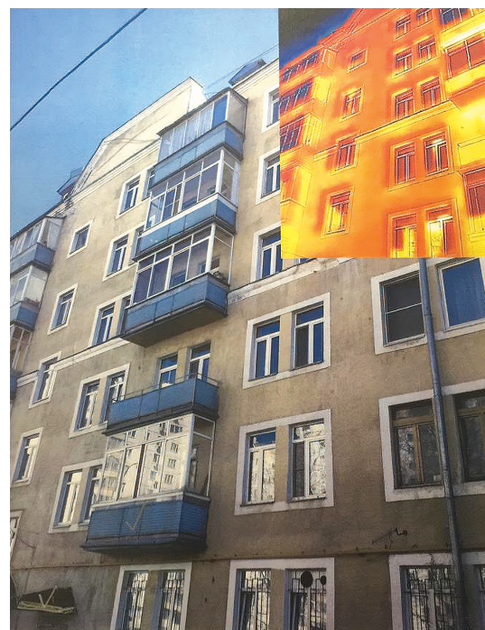
Фото 2. Тепловизионное обследование дома по ул. Большая Очаковская, дом 30. Фото предоставлено правлением ТСЖ «Надежда»
