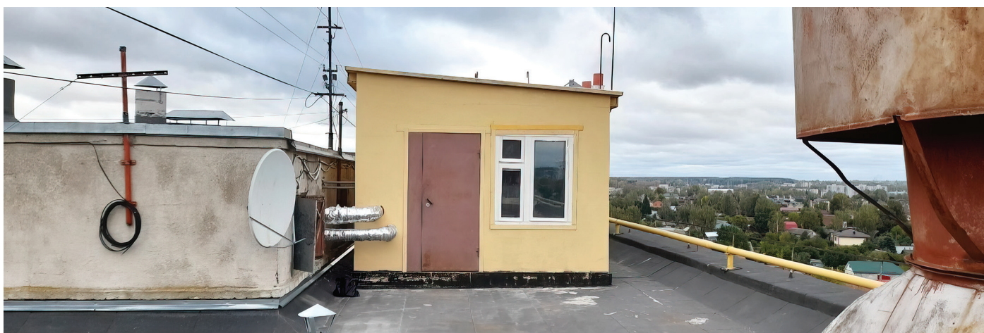
Фото 5. Газовая котельная на крыше МКД по адресу площадь Мира, дом 2. Фото ИЭГ
