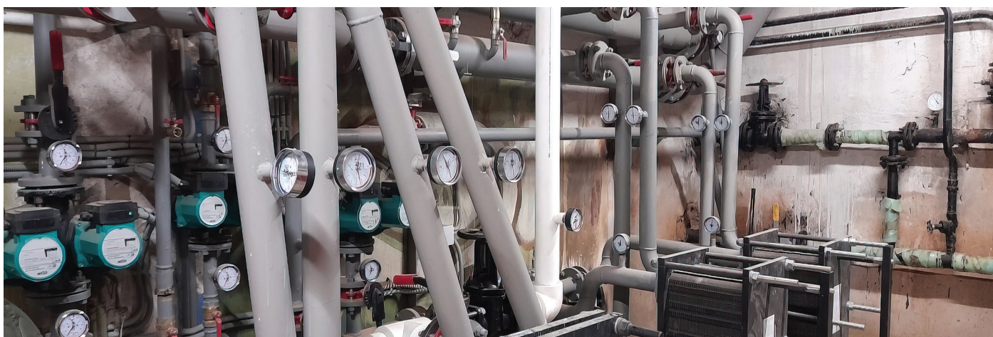
Фото 6. Тепловой узел в подвале МКД по адресу площадь Мира, дом 2. Фото ИЭГ
