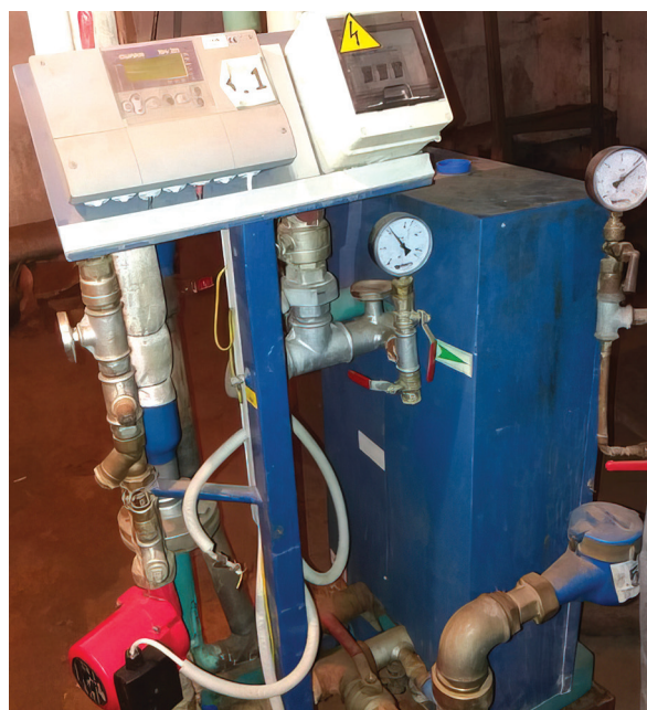
Фото 2. АИТП в многоквартирном доме №№ 6-12 по ул. Банковская (г. Калининград)
