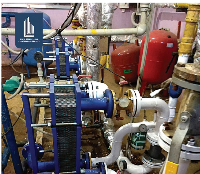
Фото 1. Пример ремонта теплового узла, организованного ЦОКР, г. Киров. Фото предоставлено ЦОКР Кировской области
