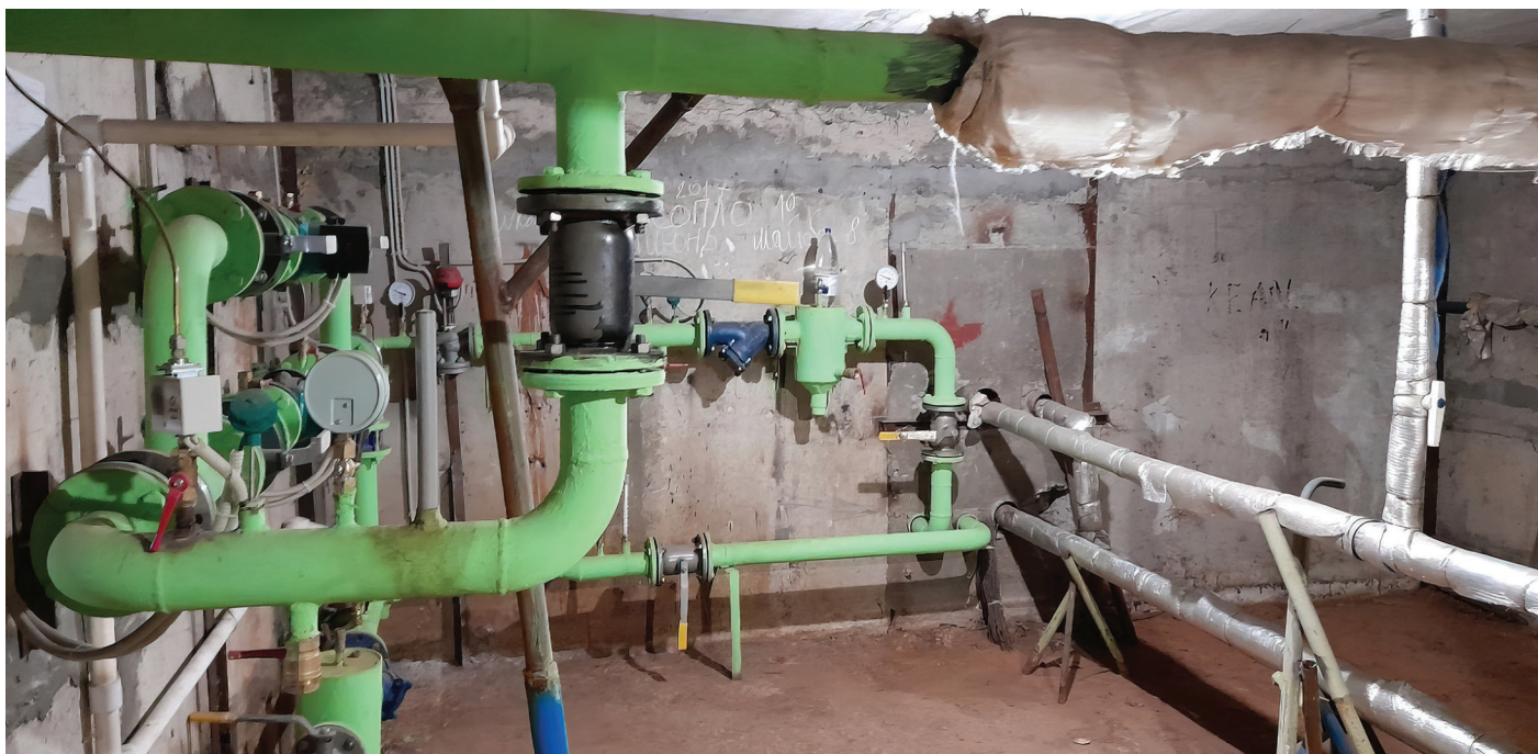
Фото 3. Тепловой узел в МКД по ул. Промышленная, 55. Фото: ИЭГ
