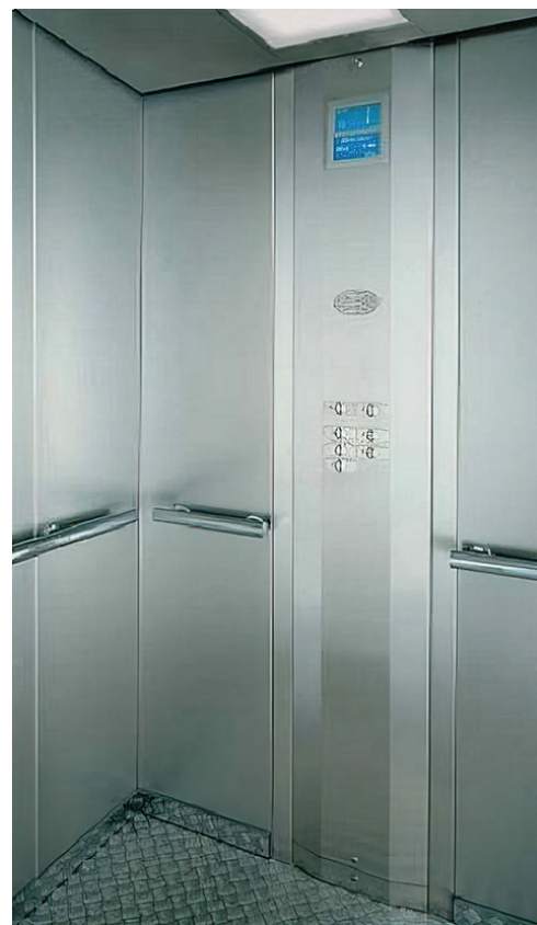
Фото 2. Вид новых лифтов в МКД по улице Генерала Кузнецова в районе Выхино-Жулебино г. Москвы. Фото предоставлено советом МКД
