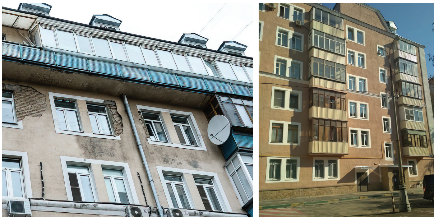
Фото 3–4. Фасад дома до и после проведения капитального ремонта дома. Фото предоставлено управлением ТСЖ «Надежда»/предоставлено управлением ТСЖ «Надежда»
