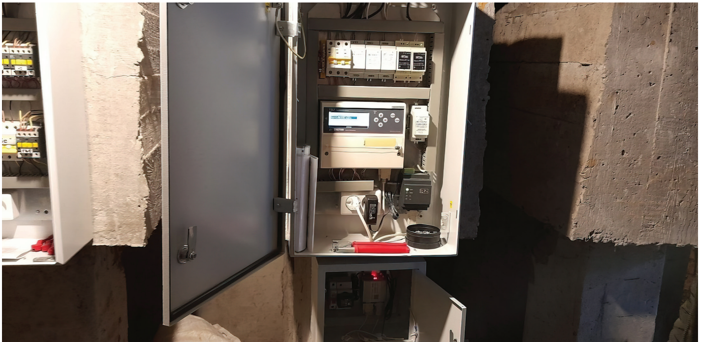
Фото 3. Щиты дистанционного управления теплоснабжения в МКД по ул. Промышленная, 38. Фото: ИЭГ
