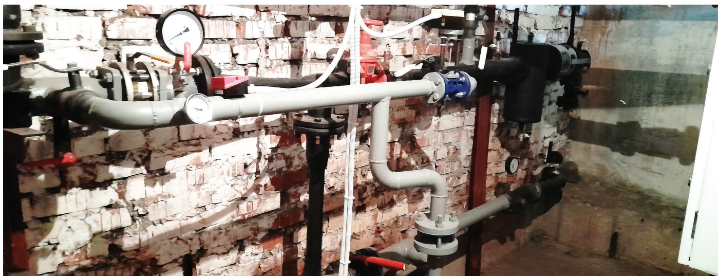
Фото 5. МКД по ул. Любецкая, 13 – отремонтированный автоматизированный узел управления внутридомовыми системами горячего водоснабжения и отопления в подвале дома. Фото ИЭГ
