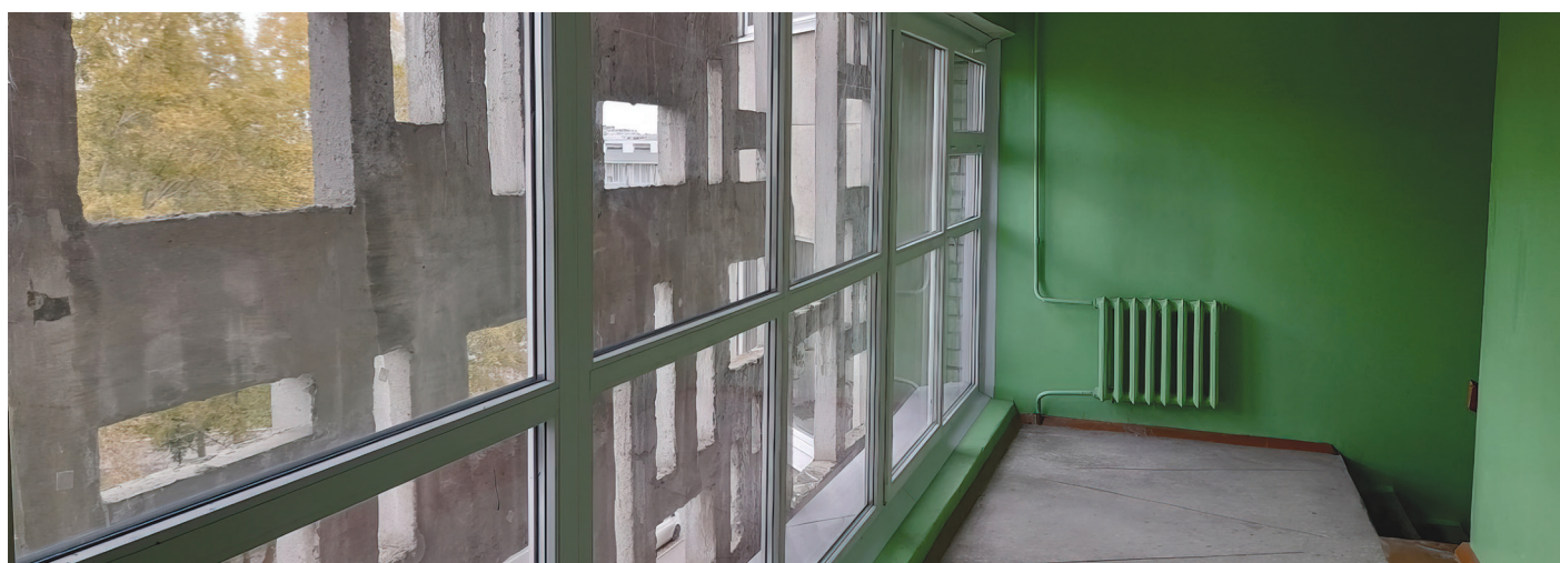
Фото 7. Новое остекление лестничных площадок в МКД по адресу площадь Мира, дом 2. Фото ИЭГ
