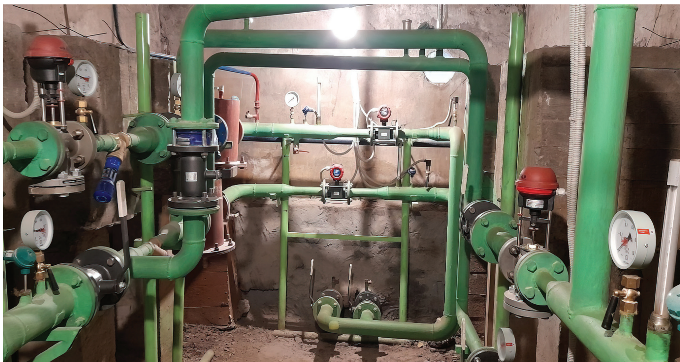
Фото 2. Автоматизированный тепловой узел в МКД по ул. Промышленная, 38. Фото: ИЭГ
