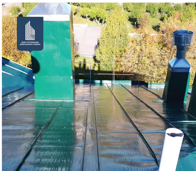
Фото 2. Пример капитального ремонта крыши, организованного ЦОКР, г. Киров. Фото предоставлено ЦОКР Кировской области
